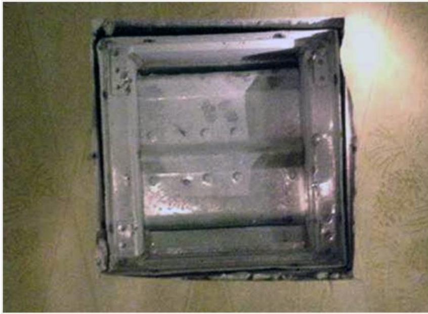
Clapet installé endommagé.
